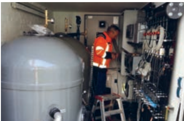
Blick in die Sanierungsanlage (im Aufbau), links die beiden Aktivkohlefilter zur Entfernung der LCKW, rechts die Zuläufe aus den Sanierungsbrunnen
