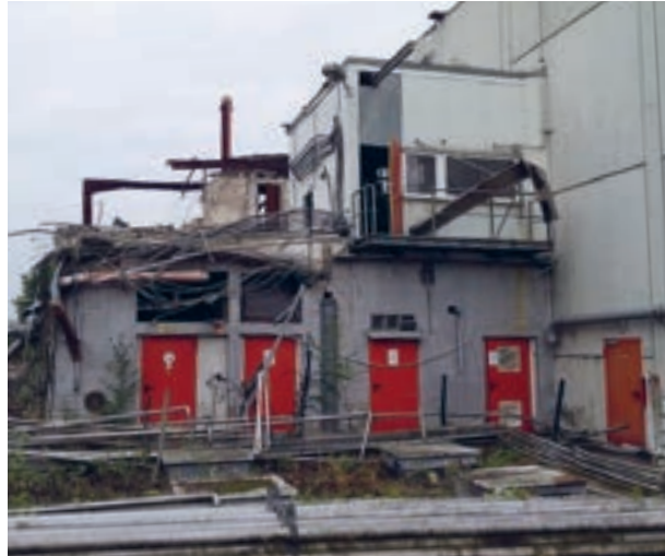
Rückansicht des Hochtanklagers
