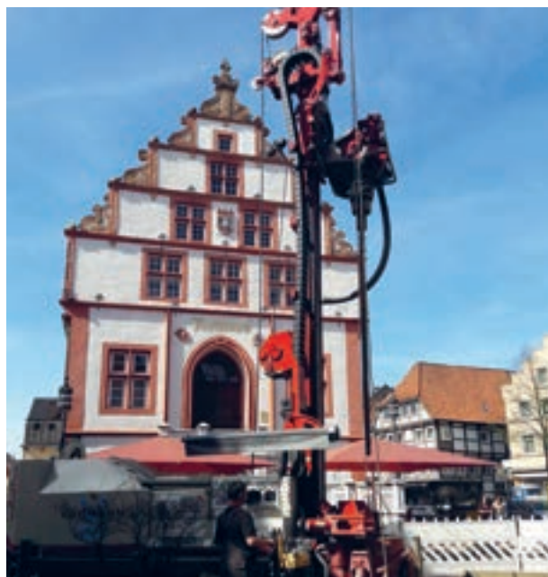
Bohrung zur Niederbringung einer der fünf Sanierungsbrunnen in Bad Salzuflen im Jahr 2018
