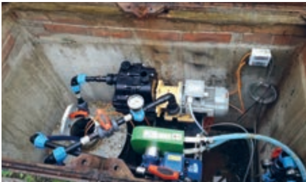
Installation in einem der Brunnenschächte mit Pumpen und Meßeinrichtungen
